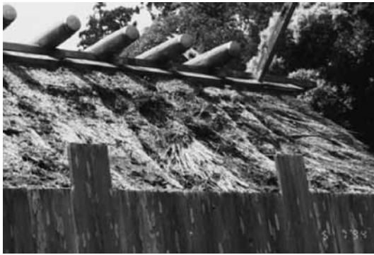
傷んだ茅葺き屋根 chaume détérioré
