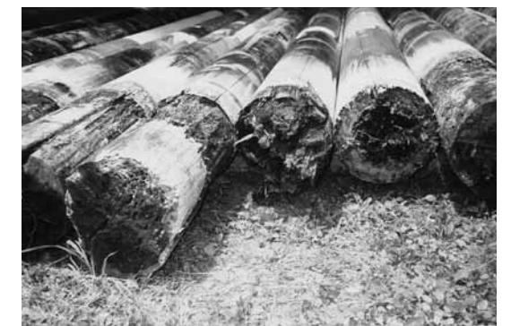
土中部分が腐蝕した柱（検査写真） photo de la vérification de la pourriture des colonnes
